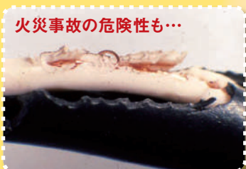
火災事故の危険性も… 金属線がむき出しの電気ケーブル
